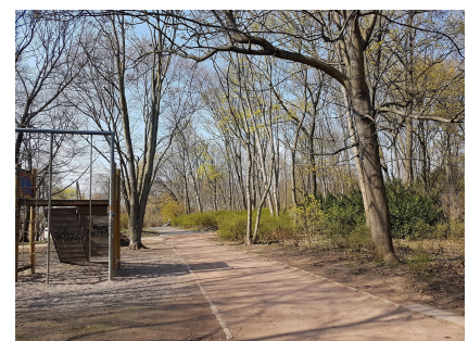
Ausspülungen an der Fitnessstrecke vor Projektbeginn
